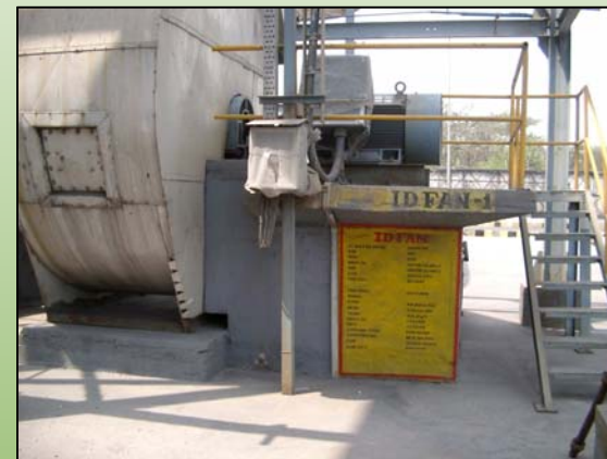
I.D. Fan – Boiler #2
